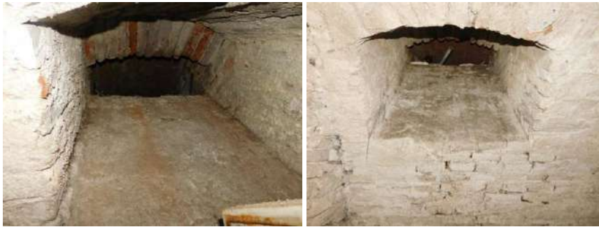
Foto nr.23, 24 Goluri la baza fundatiei blocate
