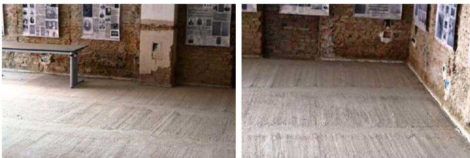
Foto nr.33, 34 Pereți cu umiditate ascensională
