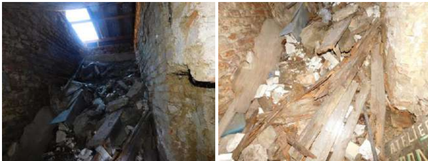
Foto nr.19, 20 Scară acces subsol distrusă
