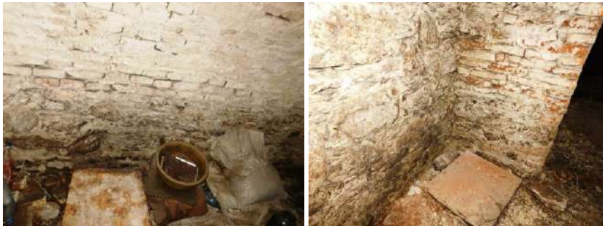
Foto nr.25, 26 Umiditate ascensională
